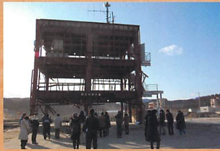
三階まで津波をかぶった防災庁舎・ 南三陸
